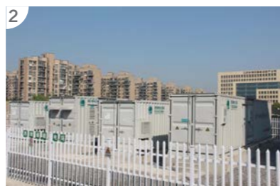
杭州未来科技城西坝储能项目
