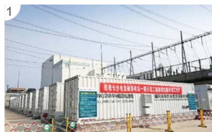
湖南长沙榔梨储能电站项目
